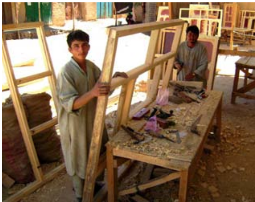
Lokale snedkere fra Sharak-distriktet i det centrale Afghanistan er i gang med at renovere en skole. Projektet er skudt i gang af CIMIC (civilt-militært samarbejde).
