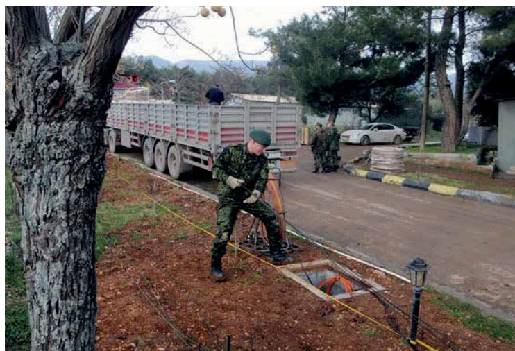
En dansk soldat trækker kabler. Den danske enhed kommunikerer både via fastnet og satellit. Foto:Privatfoto fra DGM-enheden
